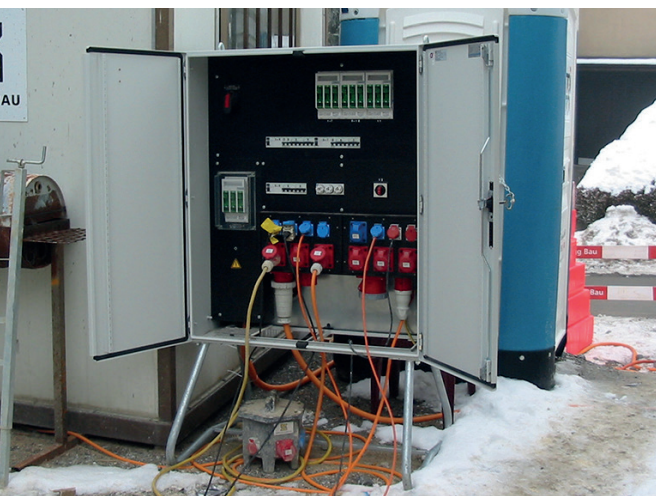
Hauptverteiler auf der Baustelle
