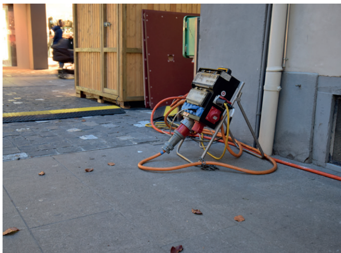
Mobiler Stromverteiler im Einsatz bei Märkten
