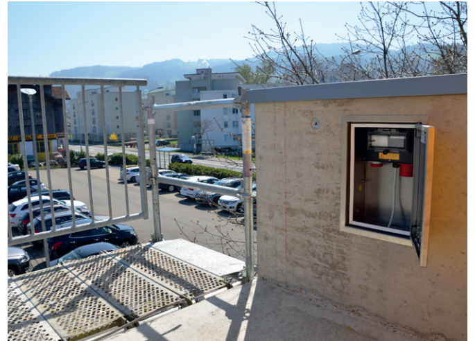
Unauffällig verbauter Unterputz-Verteiler
