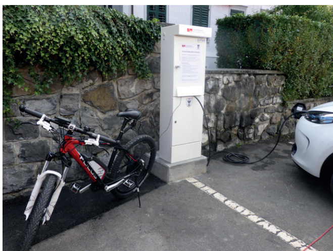
Ladesäule für E-Autos EBS Schwyz
